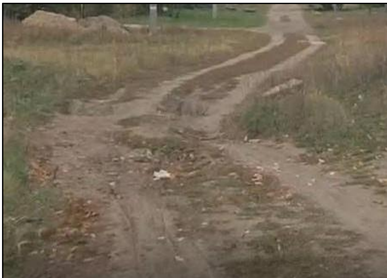
Фото 1.3.6 – Фрагмент грунтовой дороги ул. Котовского
